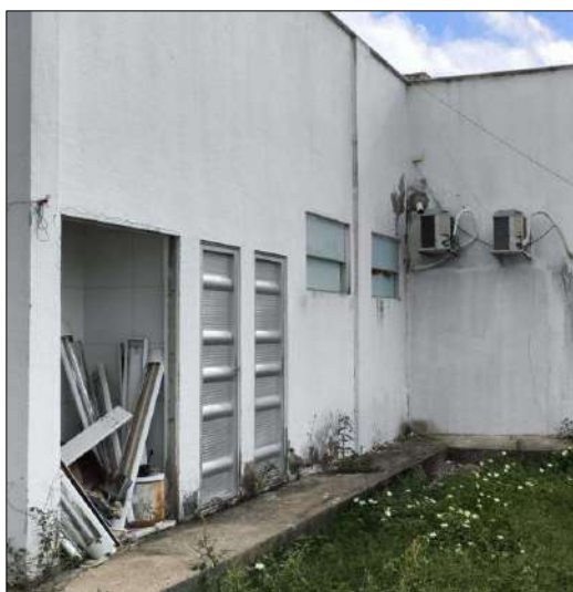
FIGURA 14 - SITUAÇÃO ATUAL: PORTAS EXTERNAS
